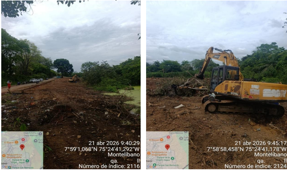
Figura 3. Remoción de la cobertura vegetal por la intervención de la maquinaria amarilla en el municipio de Montelíbano -Córdoba.
